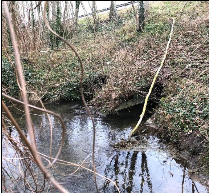
Tête amont des 2 buses métal sous la RN37
